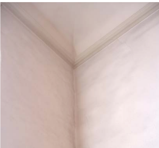
Schadhafter Putz im Innenraum
