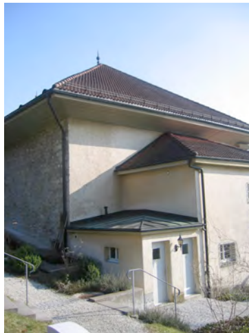
Bild 5 Risse im oberen Bereich der Nordwand
